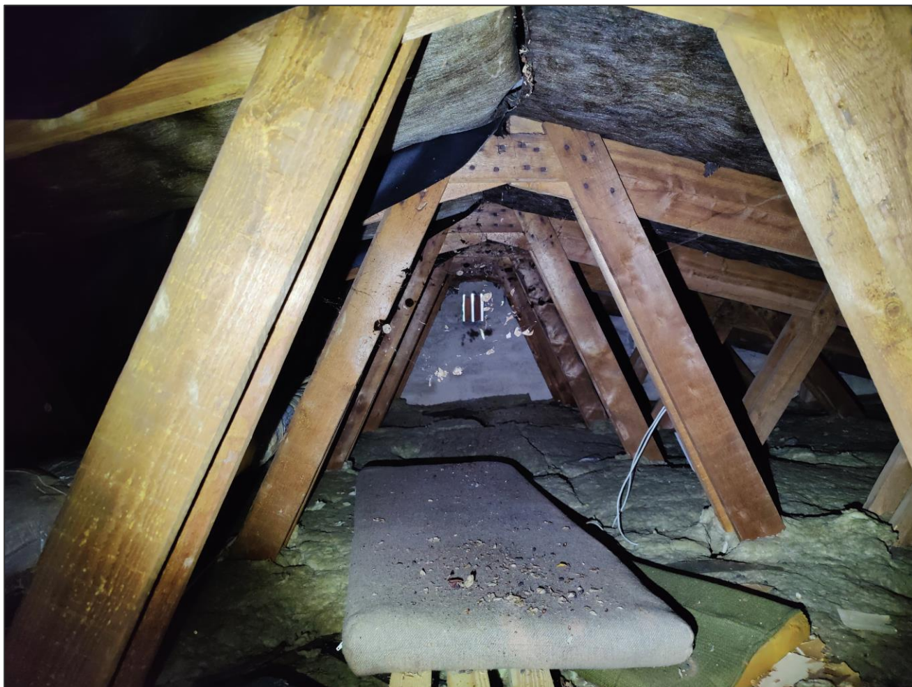
Figur 2.2: Loftet under taget på Kollekollevej 27. Der var spredt rotteafføring ud over hele loftet. Langs loftet hang tykke lag af spindevæv, som ikke indikerer at flagermus flyver rundt i hulrummet. Ved gavlen kunne flagermus potentielt komme ind, men der var ingen tegn på afføring eller andre spor efter flagermus ved gavlen.
