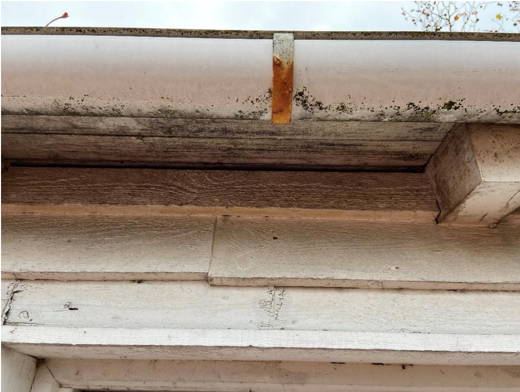
Foto 2. Sprække under tagudhæng på træskur som giver adgang til tagkonstruktionen.
