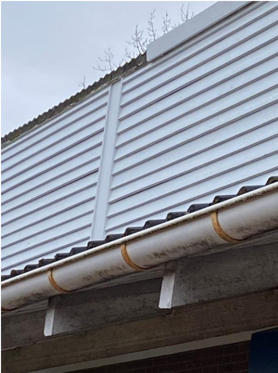
Foto 6A. Byggefelt 23, 24, 25 og 26: En del af kanten i tagkonstruktionen er faldet af. Ud fra dette kan bygningerne afvises som levested for flagermus.
