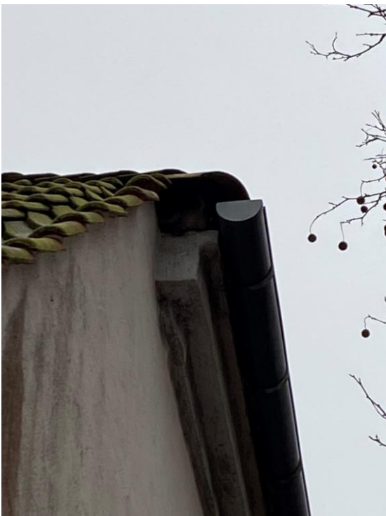
Foto 9A. TF1 : Hul ved tegl i tagkonstruktionen.
