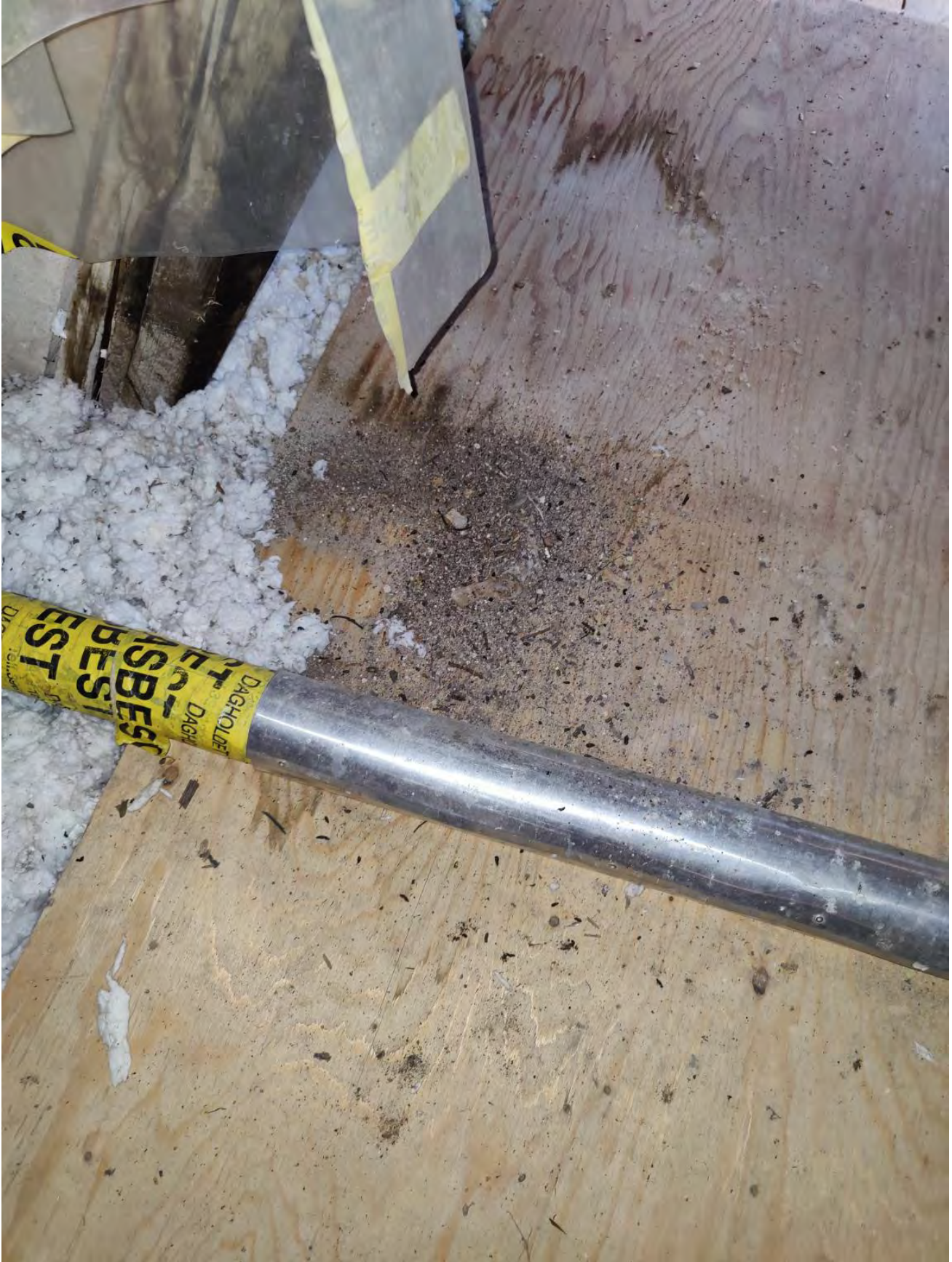
Figur 4.3: Mindre afføringsrester fra flagermus, som er faldet ud af sidelemmen på skorstenen i bygning 1.
