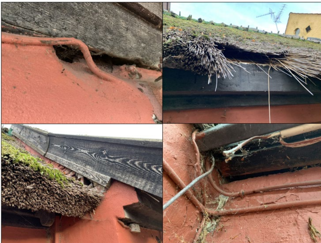
Figur 4.1: Billeder af huller og sprækker i den udvendige facade. Fotos: Niras A/S, den 13. oktober 2022.
