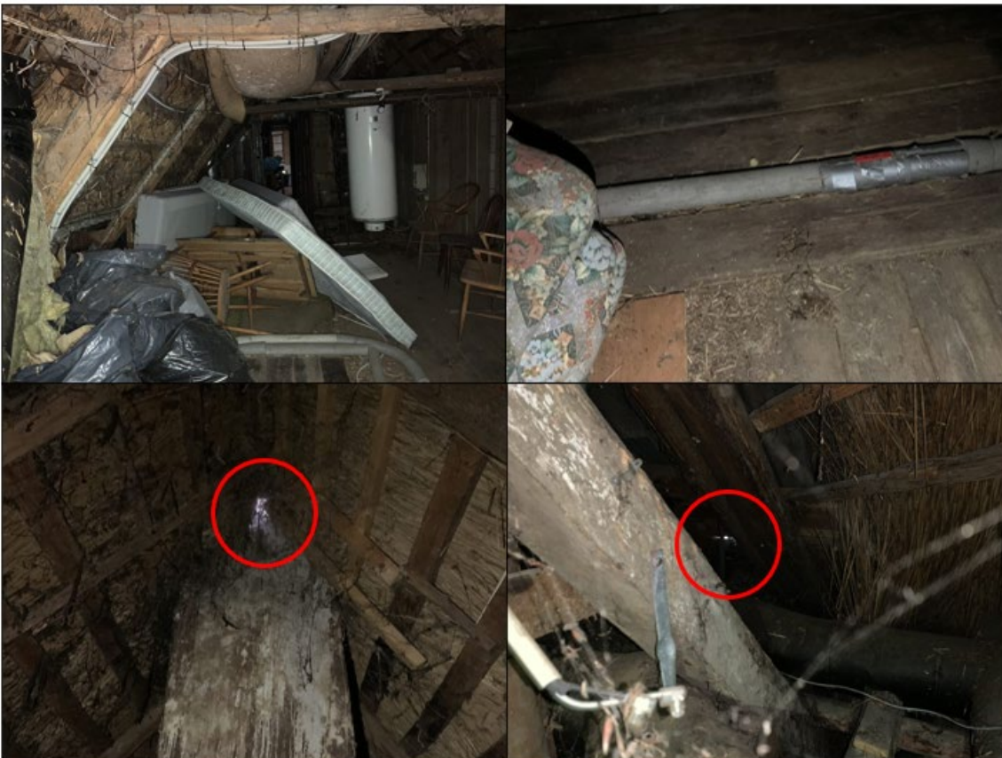
Figur 4.2: Øverst t.v. ses en del af loftsrummet. Øverst t.h. ses et frostsprængt vandrør der er blevet foret. Nederst t.v og t.h. ses to fotos af huller i stråtaget (markeret med rød cirkel). Fotos: Niras A/S, den 13. oktober 2022.
