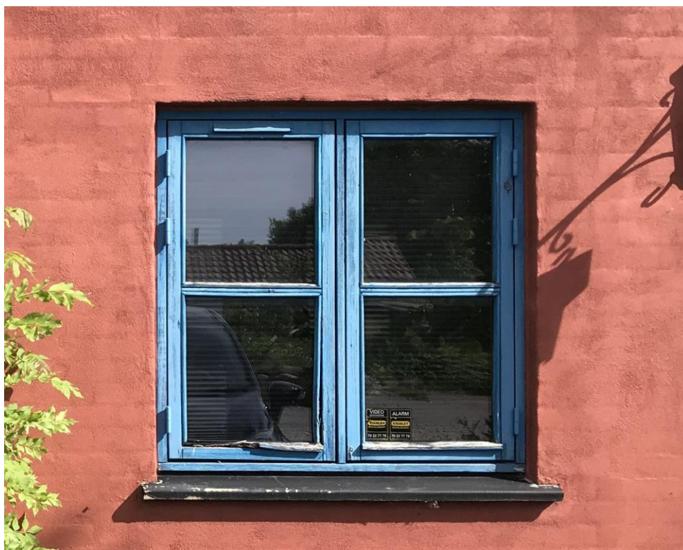
Foto maj 2022. Vinduer er ikke oprindelige. De nuværende termovinduer er dateret 1987 og fremmede for et historisk hus.
