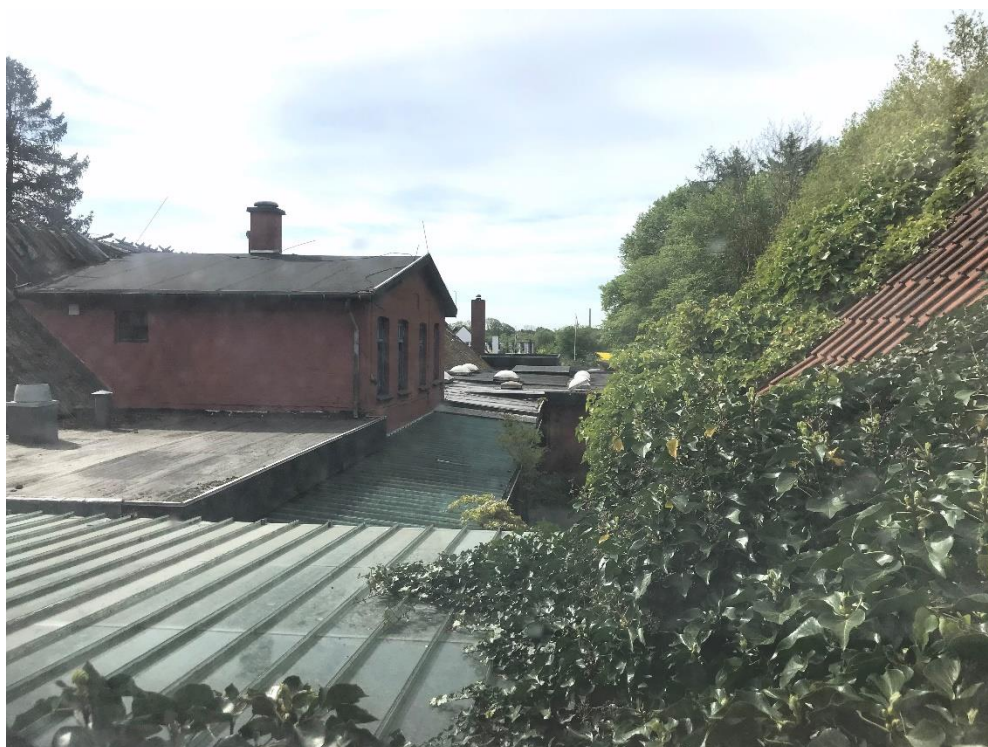
Foto maj 2022. Kig fra gangen på 1 sal i den tidligere rejsestald giver indtryk af, hvor komplekst anlæggets bagside er blevet, med et virvar af forskellige udbygninger og tagmaterialer.
