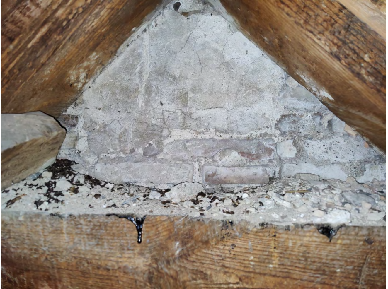
Figur 4.4: Afføring fra flagermus ved endegavl i bygning 1.
