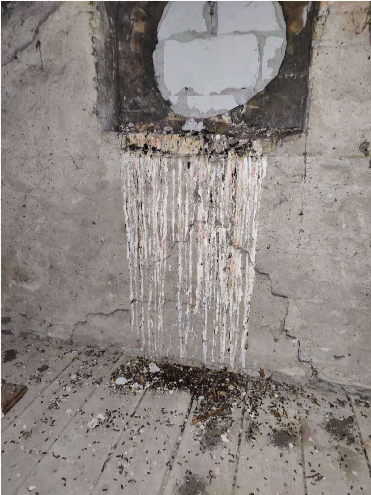
Figur 4.1: Efterladenskaber fra en koloni af flagermus (formodet dværgflagermus) ved endegavlen i bygning 3.
